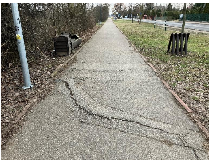
Zdjęcie 66: Uszkodzona nawierzchnia drogi pieszo-rowerowej. Źródło: własne.
