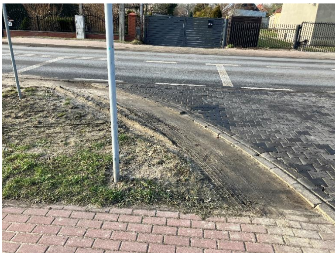
Zdjęcie 65: Uszkodzone pobocze na skrzyżowaniu ul. Kościelnej z ul. J. Kusocińskiego. Źródło: własne.
