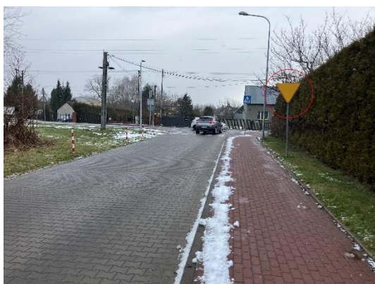
Zdjęcie 24: Znak A-7 na skrzyżowaniu ul. J. Kusocińskiego z ul. Kościelną – brak wymaganej widoczności. Źródło: własne.
