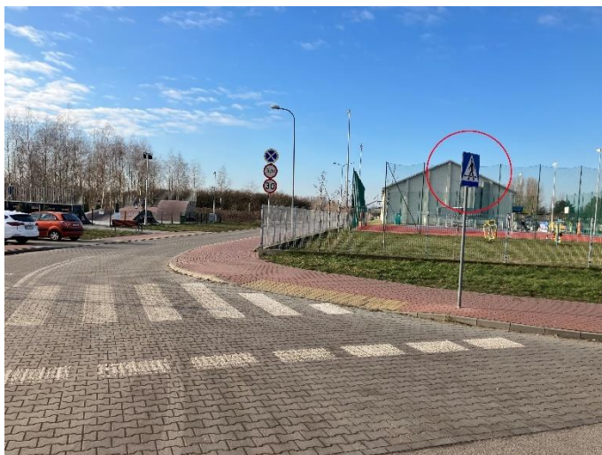
Zdjęcie 34: Przekręcona tarcza znaku D-6 „przejście dla pieszych”. Źródło: własne.
