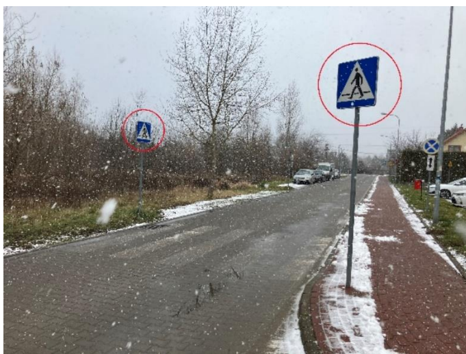
Zdjęcie 36: Przekręcone tarcze znaków D-6 „przejście dla pieszych”. Źródło: własne.
